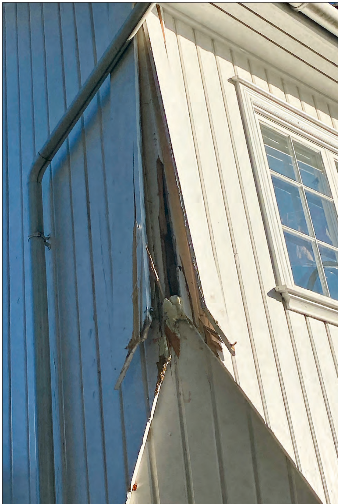
SKADET: Slik så husveggen ut etter at bussen traff veggen.
