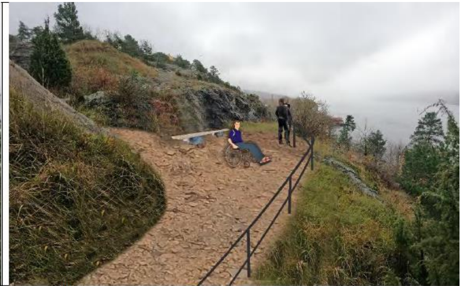
Kanonstilling mot syd med rekkverk, sti og sittebenk i eik og stein
